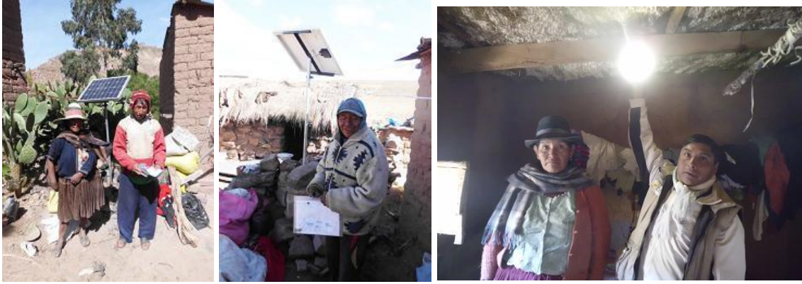
Sistemas fotovoltaicos compactos para centros de carga solar para trampas de luz – Norte de Potosí (2014). En épocas sin plagas, las lámparas se utilizan para iluminar las casas.
